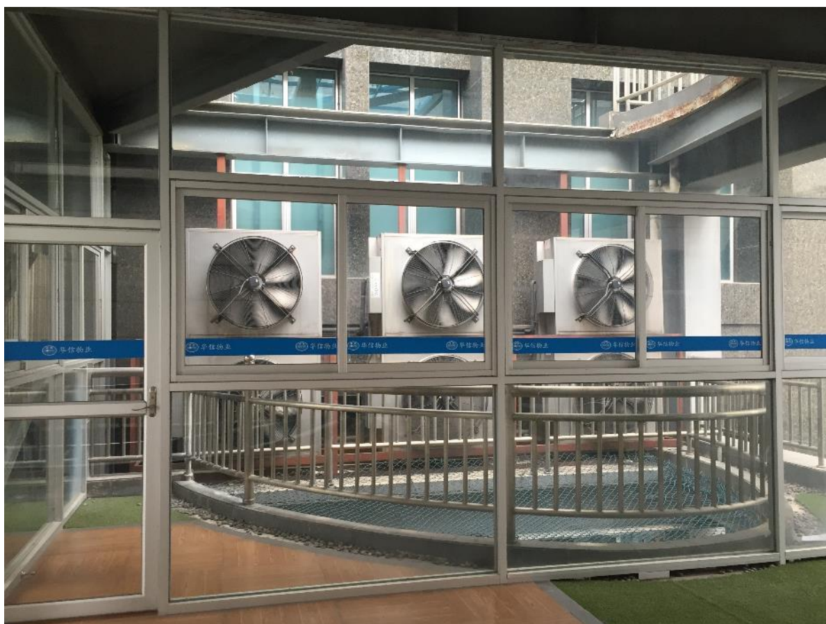
计算机机房精密空调悬挂处隔音玻璃
