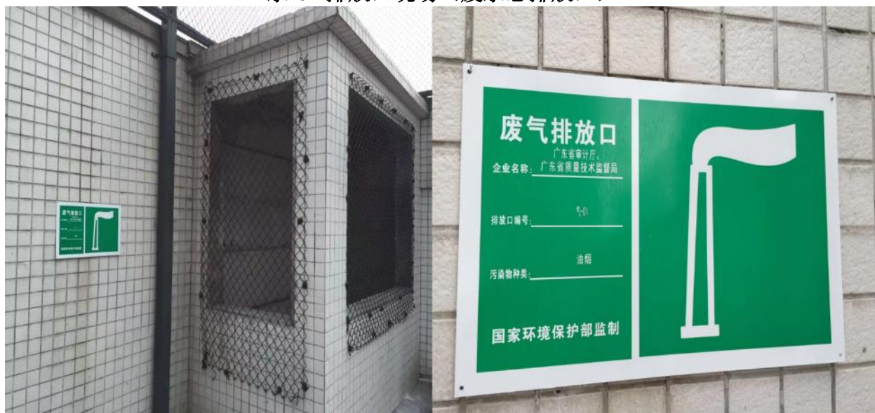
气-01 排放口现场（厨房油烟排放口 1#）
